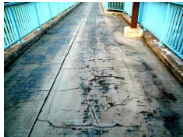
堰下橋の歩道です。痛んでいる所が目立ちます。
