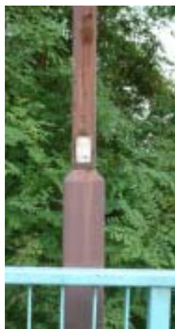
塗装が剥がれ落ちてサビが目立つ街路灯の支柱
